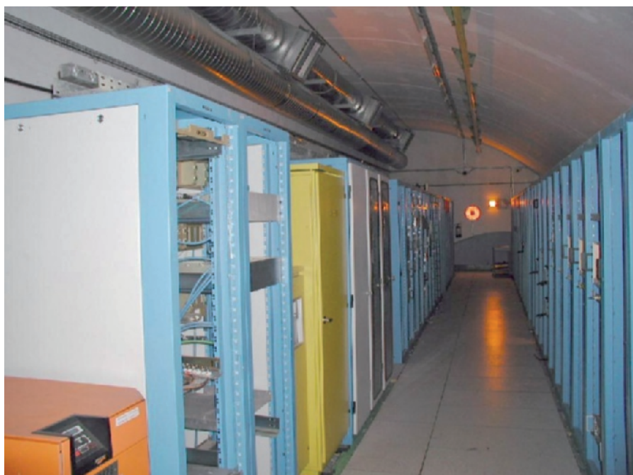
Sistema désenfumage francese. In questo centro di elaborazione dati sono stati installati due condotti separati: uno per la ripresa dell'aria e uno per l'evacuazione fumi. La normativa francese risulta oggi in Europa quella più specifica e evoluta per la realizzazione di un sistema di gestione attiva dei fumi in caso d'incendio.
