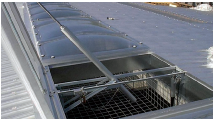
Evacuatori di fumo e calore disposti in batteria in copertura. La normativa italiana ne regola in modo preciso sia la funzionalità che l'utilizzo. Viceversa poco o niente viene detto quando per condizioni sfavorevoli (fumi freddi, vento, pressurizzazione) la loro efficacia ne venga sensibilmente compromessa.
