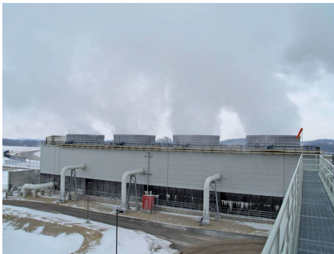
La formazione di nebbie da parte delle torri di raffreddamento d'acqua va assolutamente prevenuta quando la loro installazione è in prossimità di strade di traffico e di nodi autostradali.
